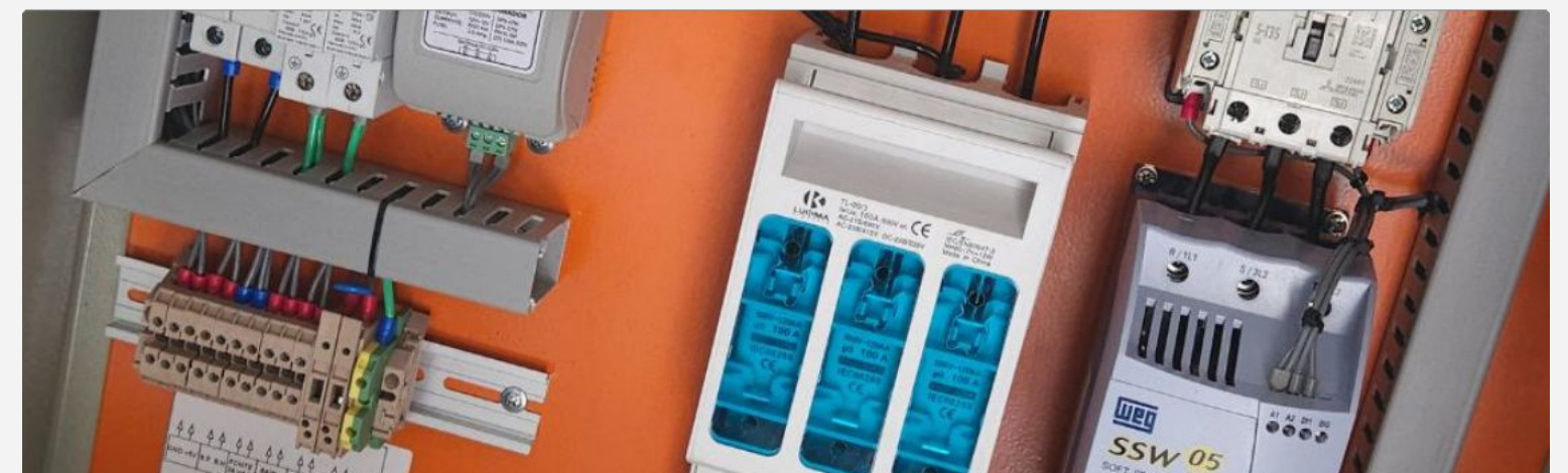
Painel Soft Starter Isolado.
